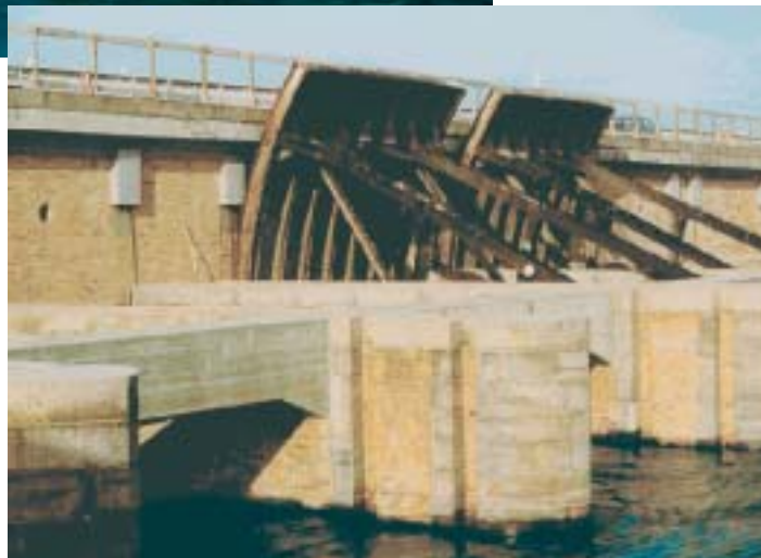
Fig. 5. Slusen i Hvide Sande affugtes for at beskytte maskineriet.
