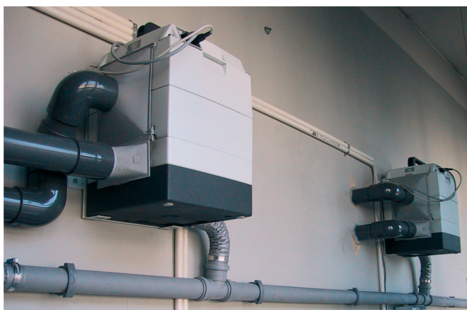
Affugtningssløsning ved kølerum.
