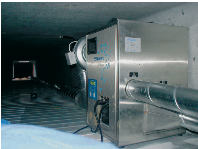
2 affugtere af typen MCS300 er installeret over fryserummet og forhindrer kondensdannelser.
