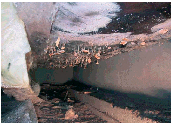
Svampevækst i krybekælder forårsaget af for høj og ukontrolleret luftfugtighed
